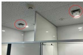
アクセシビリティ設備の例 (光警報装置)
